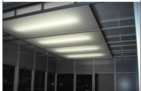
Deckensystem mit Beleuchtung
